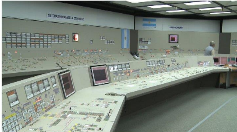
Foto: Sala de Control Principal de la Central Nuclear Atucha II
